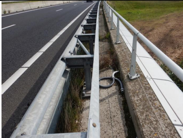
Schade (101): Geleiderail - staal -
